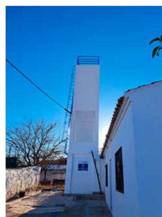
Las obras de mejora e instalación de un nuevo depósito de 16.000 litros de un solo vaso, en la pedanía de Villarreal , ha solucionado los problemas de abastecimiento y de presión.
