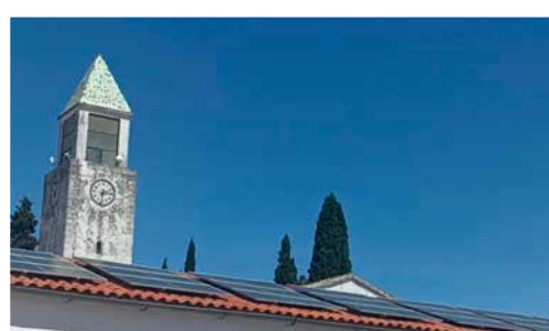
La instalación solar fotovoltaica en los colegios públicos del CRA La Raya, tanto en San Benito de la Contienda, San Jorge de Alor, San Francisco y San Rafael , suponen un ahorro energético del 50%.
